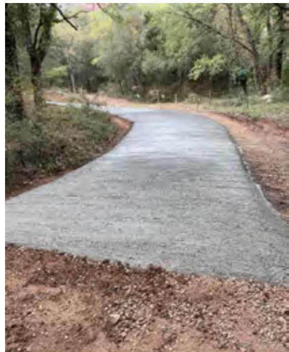
Estat final de l'accés al pàrquing de l'àrea d'esplai del pantà de Sau. Font: Arxiu XPN
