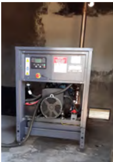
Nou generador de corrent a les instal·lacions del clorador i el dipòsit de l'Àrea d'Esplai del Corredor. Font: Arxiu XPN
