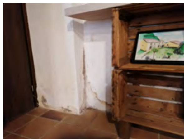
Estat de les parets interiors de Can Pica abans del tractament. Font: Arxiu XPN
