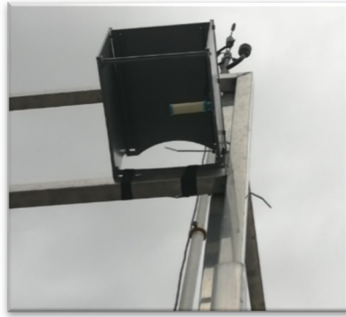
Figura 9. Captador passiu instal·lat a la Unitat Mòbil
