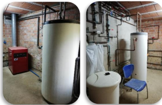
Sala de màquines
